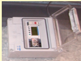
冷ケース防露ヒータ制御
