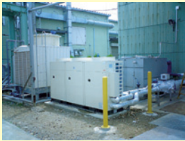
高効率チラーシステム
