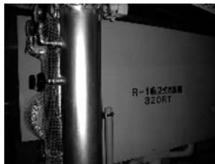
吸収式冷凍機
