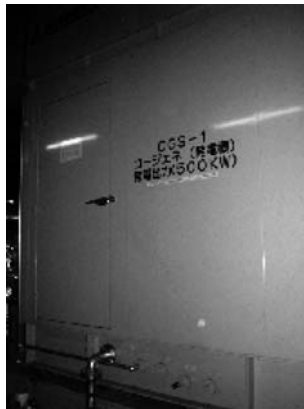
コージェネレーション（発電機）
