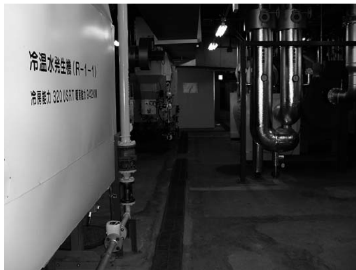
ターボ冷凍機、冷水水発生機
