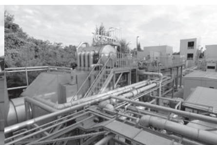
ガスタービンコージェネレーション設備
