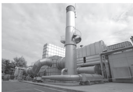
国内最大級の蓄熱式脱臭装置
