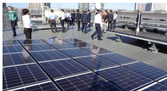
▲屋上に設置される太陽光発電設備
